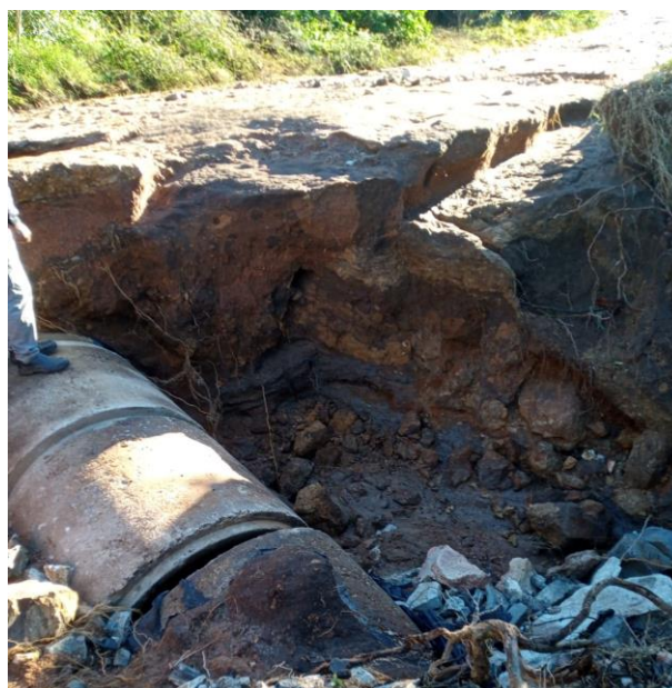
Foto 81 - Diversos acessos intransitáveis em Arroio Grande
