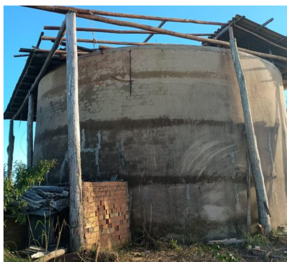
Foto 11 - Silo destelhado em função dos temporais em Arroio do Meio
