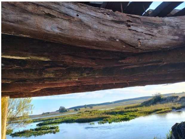
Foto 52 - Estrutura de ponte danificada no acesso aos assentamentos em Santana do Livramento
