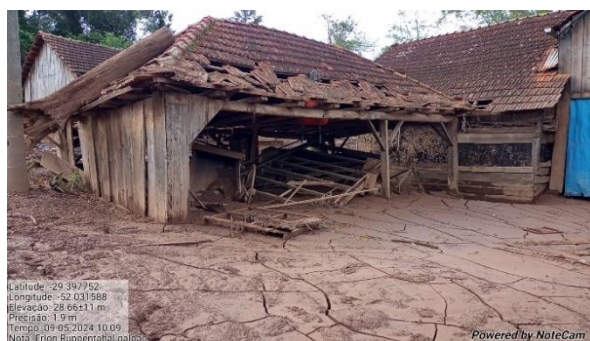
Foto 6 - Galpão soterrado em Arroio do Meio
