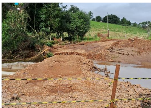
Foto 66 - Ponte danificada no acesso aos assentamentos em Jóia
