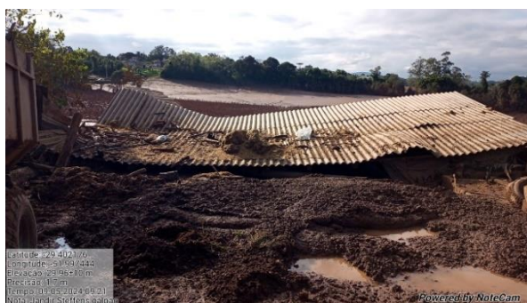
Foto 5 - Destruição total de sala de ordenha e galpão em Arroio do Meio
