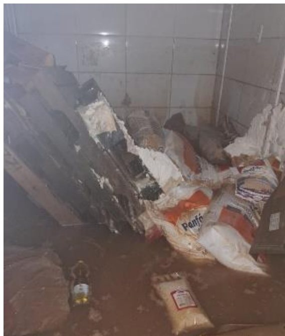
Foto 85 - Estrutura de agroindústria após enchentes em assentamento, em Nova Santa Rita
