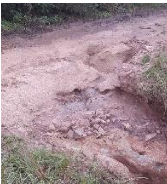
Foto 80 - Danos nas estradas em Arroio Grande
