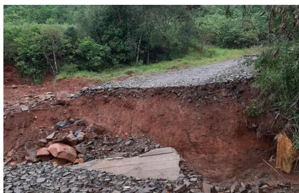
Foto 61 - Bloqueio de estrada devido à queda de barreira em Aratiba
