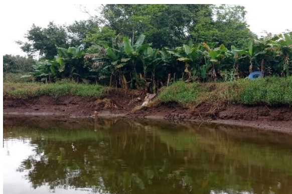
Foto 40 – Açude (piscicultura) com talude rompido, na propriedade da família Dietrich, Linha Buricá, em São José do Inhacorá
